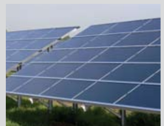
KLEMENS XL als Unterkonstruktion für AluTec FL: Gewer-bepark Breisgau, 1,4 MWp
