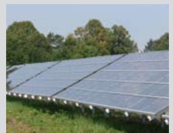
Freilandanlage im Gewerbepark Breisgau
