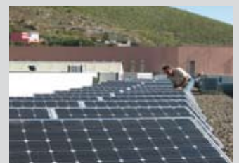
Deutsche Schule, Teneriffa, 88kWp
